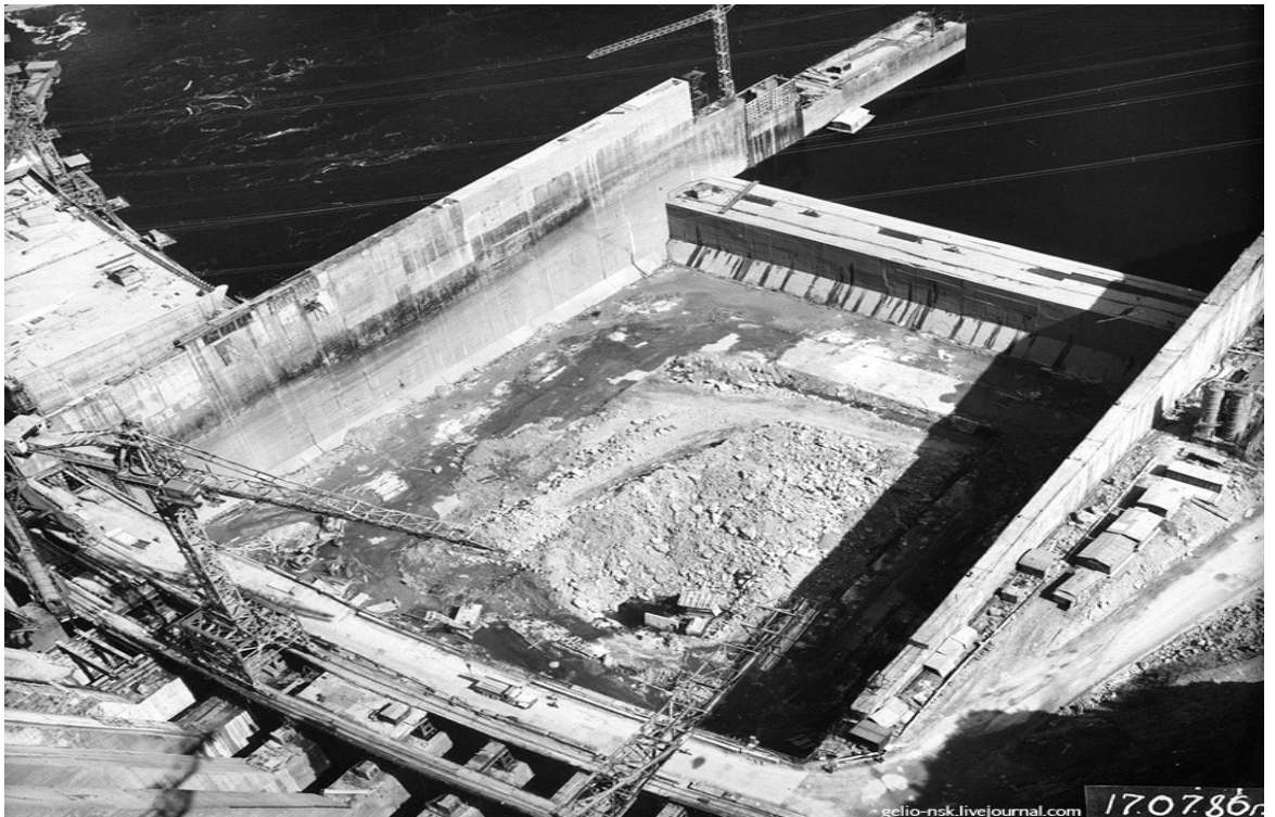
Рисунок 1.5 – Водобойный колодец СШ гидроузла с разрушенным дном (автор Козлов Д.В.)
